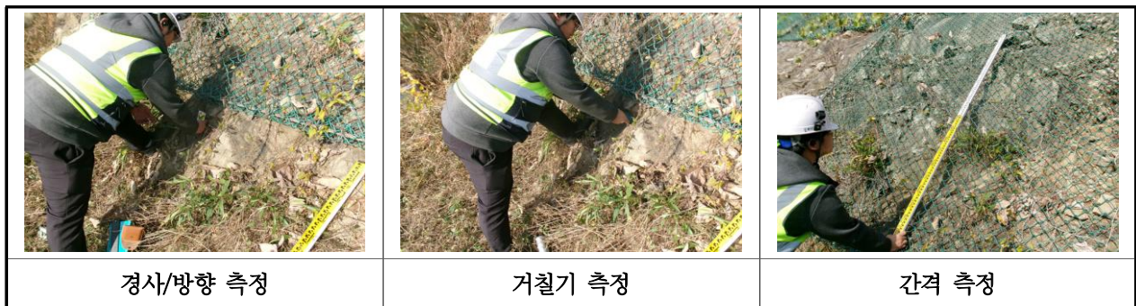
【사진 34.3.2】 불연속면 측정 현황
